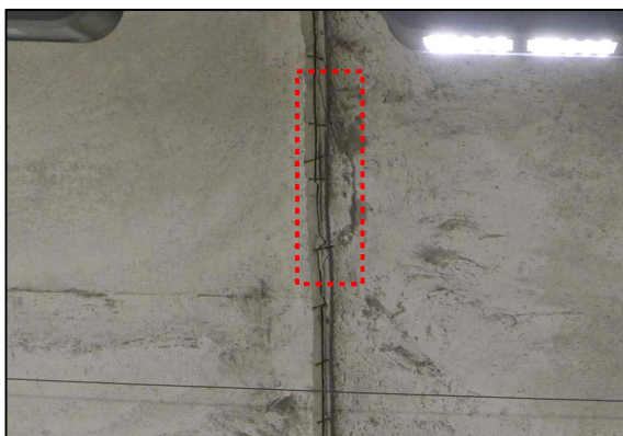
q. 천단부 S71(J71) 시공이음부 박락
