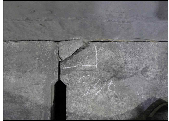
b. 공동구 S38 덮개 파손
