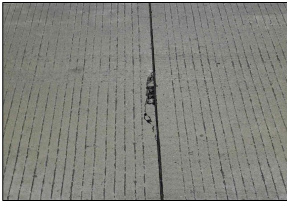
c. 포장부 S18 줄눈 주변 파손
