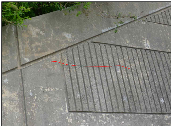
c. 갯구부 옹벽(시점 좌측) 균열(0.3mm이상)
