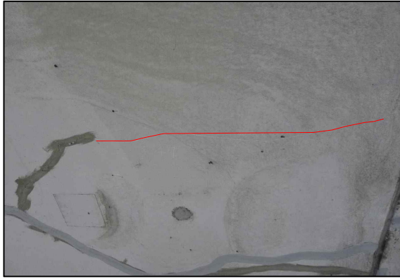
k. 천단부 S47 균열(0.3mm미만)
