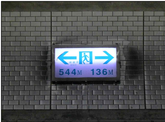
a. 비상구 표시등 설치현황
