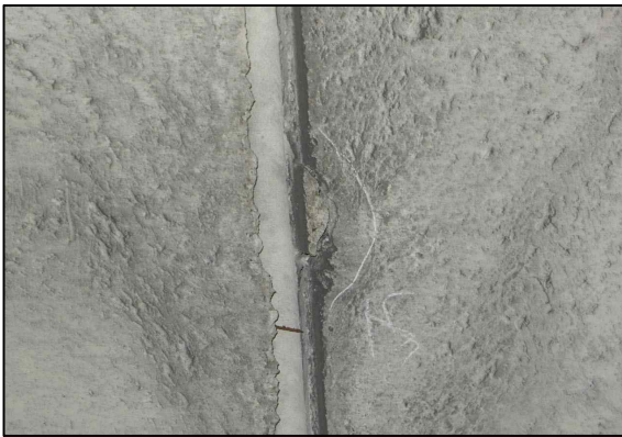
e. 천단부 S15(J15) 시공이음부 박락
