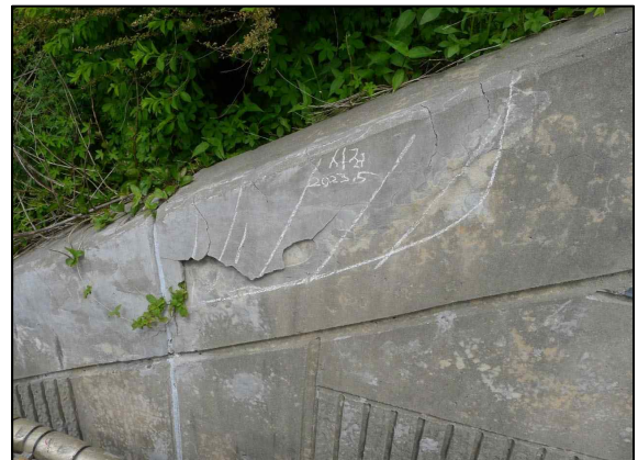
d. 갯구부 옹벽(시점 좌측) 보수부 들뜸, 박락
