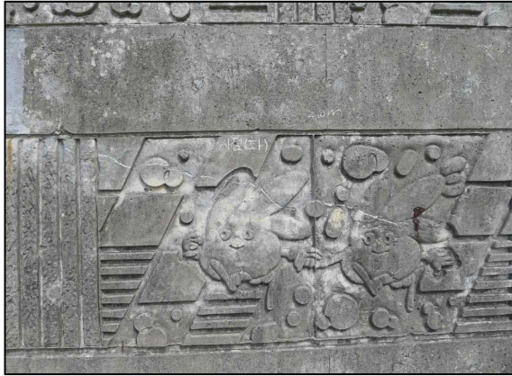
a. 갯구부 옹벽(시점 좌측) 균열(0.3mm미만)
