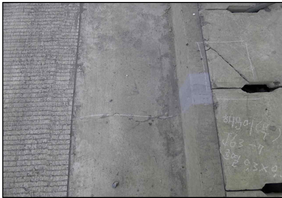
c. 측구 S63 균열(0.3mm미만)
