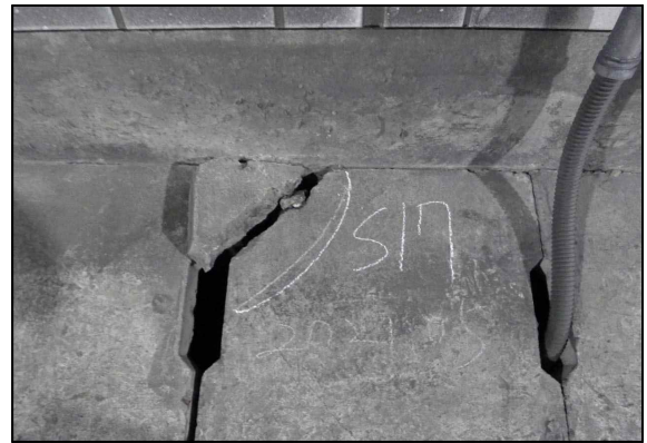
d. 공동구 S17 좌측 덮개 파손
