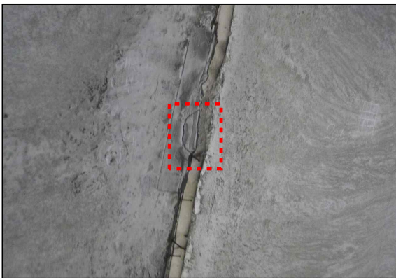
i. 천단부 S44(J44) 시공이음 보수부 박락
