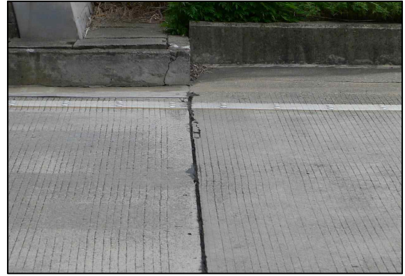
b. 포장부 S1 줄눈 주변 파손
