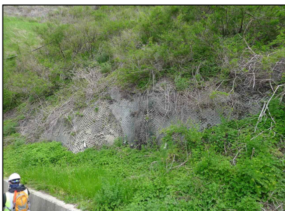
a. 시점부 사면 녹생토 탈락
