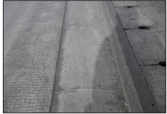
b. 측구 S16 균열(0.3mm미만)
