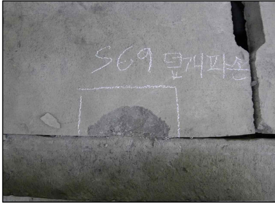
i. 공동구 S69 좌측 덮개 파손
