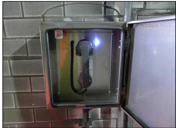
b. 비상전화시설 설치현황
