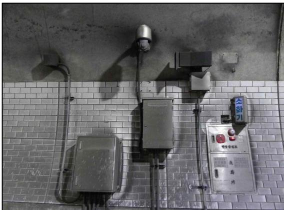
c. 터널 내부 CCTV 설치현황
