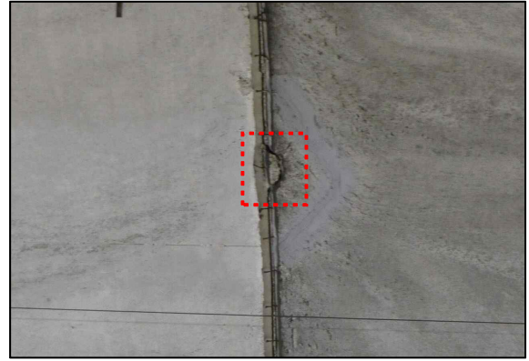
l. 천단부 S50(J50) 시공이음부 박락
