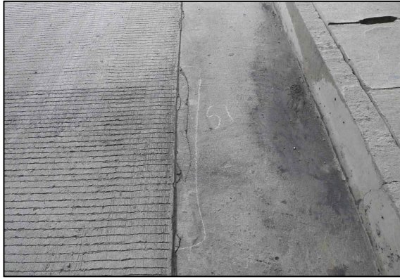
a. 측구 S1 좌측 파손
