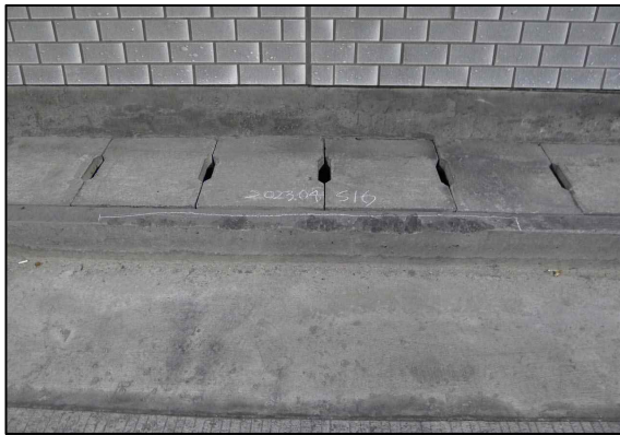
c. 공동구 S16 좌측 파손
