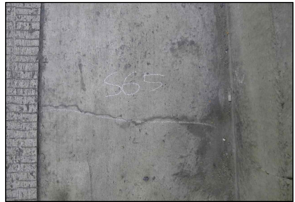
d. 측구 S65 균열(0.3mm미만)
