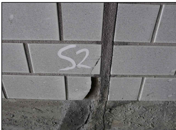
a. 측벽부 S2 좌측 타일탈락, 파손
