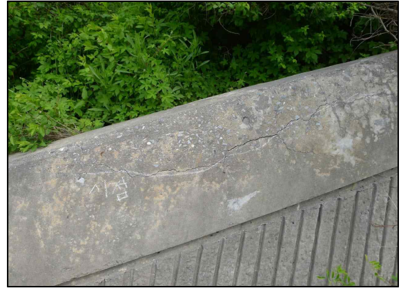
b. 갯구부 옹벽(시점 좌측) 균열(0.3mm이상)
