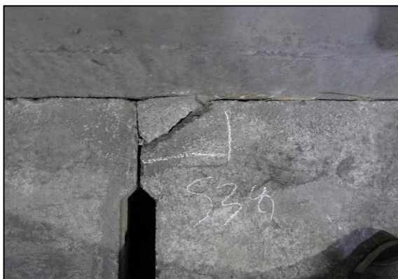
e. 공동구 S38 좌측 덮개 파손
