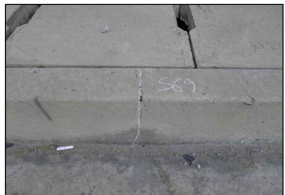
h. 공동구 S69 측면 균열(0.3mm미만)
