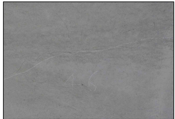
j. 천단부 S46 균열(0.3mm미만)
