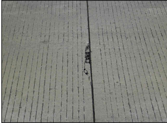
a. 포장부 S18 줄눈 주변 파손
