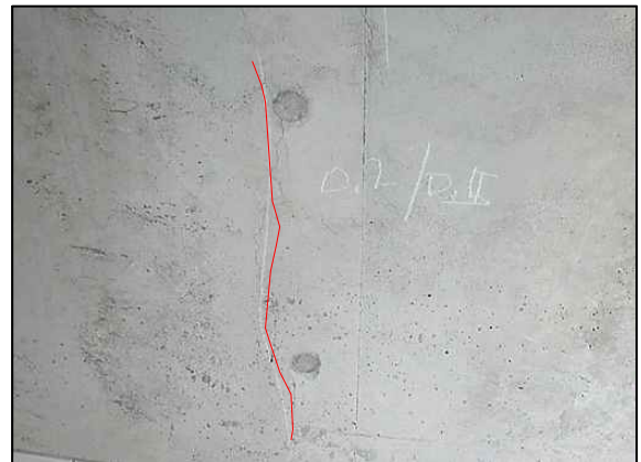
f. 측벽부 S76 좌측 균열(0.3mm미만)
