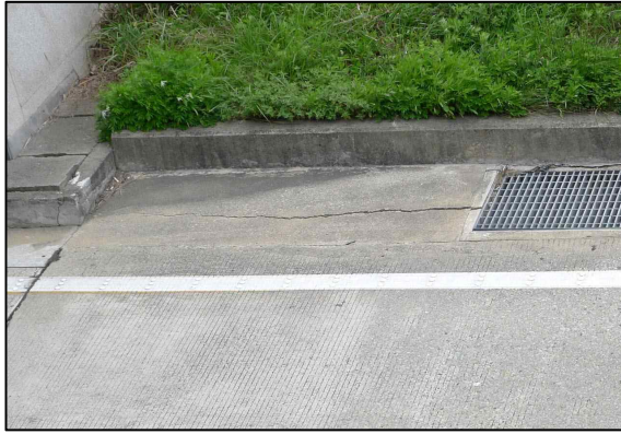
a. 포장부 S1 접속부 균열
