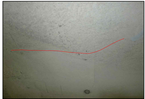
f. 천단부 S22 균열(0.3mm미만)
