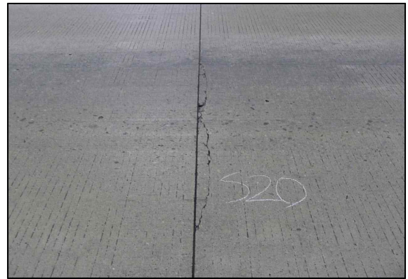
d. 포장부 S20 줄눈 주변 파손
