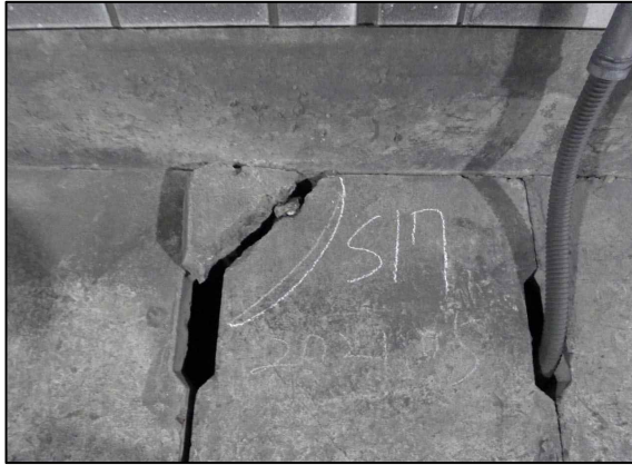
a. 공동구 S17 덮개 파손
