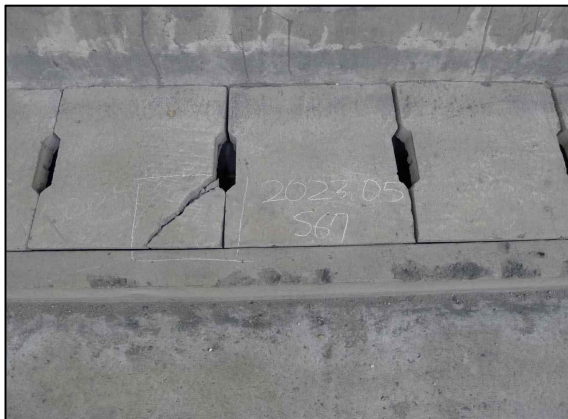
c. 공동구 S67 덮개 파손
