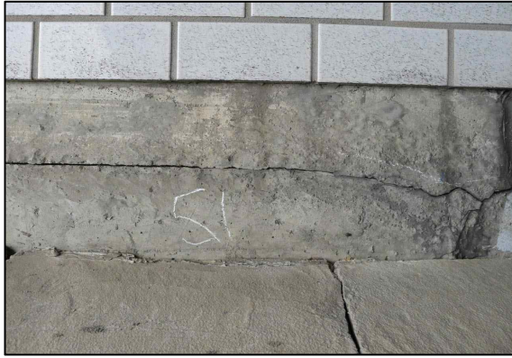
a. 공동구 S1 좌측 시공이음 균열(0.3mm이상)
