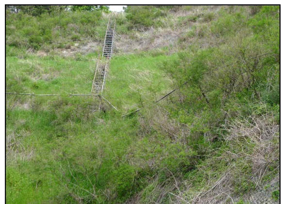
b. 시점부 웬스 파손
