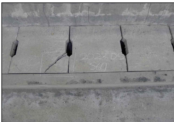
g. 공동구 S67 좌측 덮개 파손
