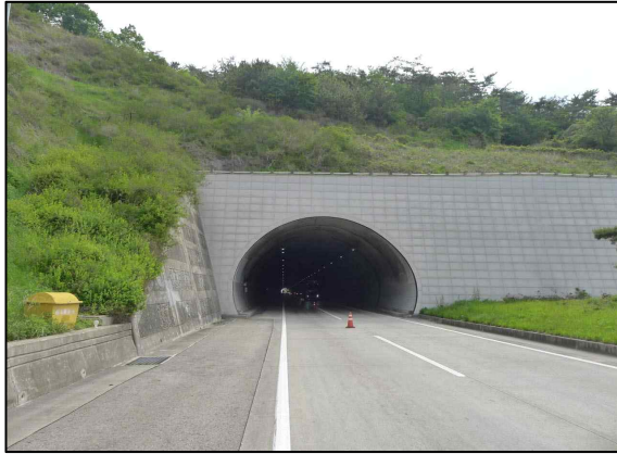
a. 시점부 갯문 상태양호
